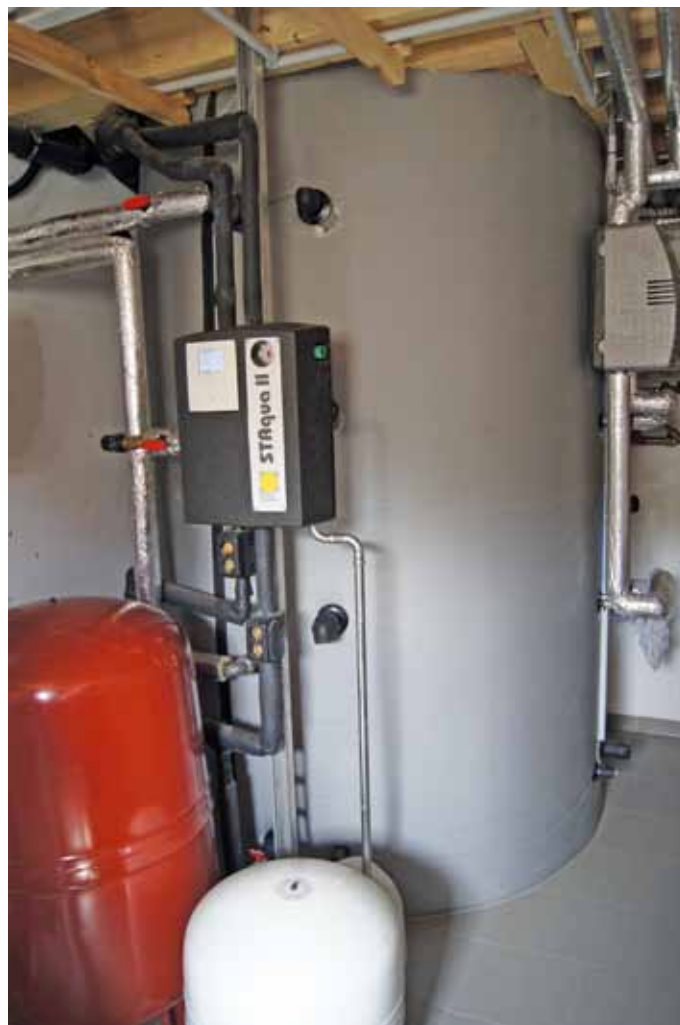
Der Solar-Pufferspeicher mit einem Nennvolumen von 3000 l befindet sich in der Haus-technikzentrale; Bild: Stefan Schön
